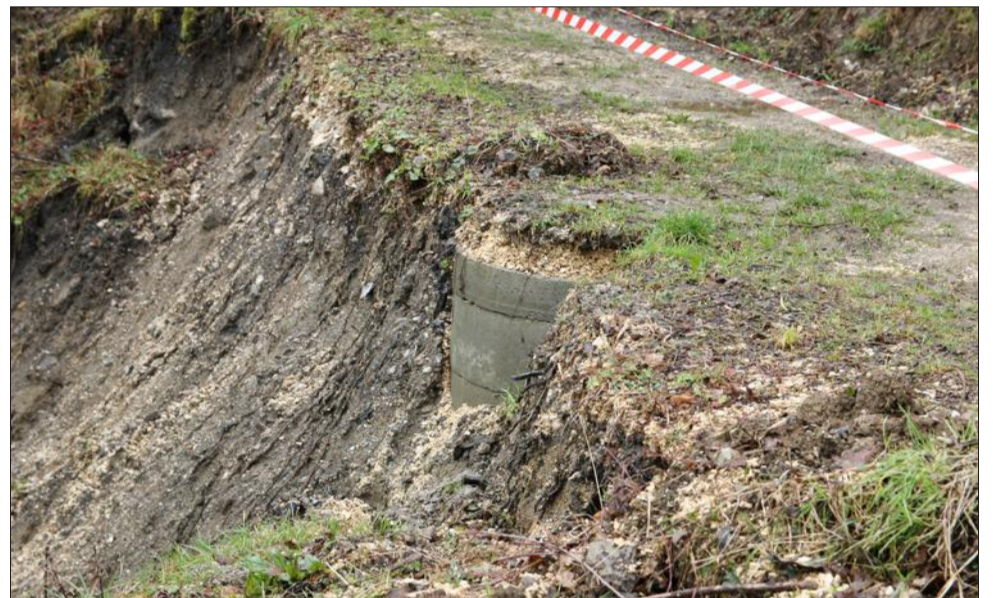
La buse en béton du réseau d'eaux usées a été mise à nue et pourrait bien être emportée si le terrain venait encore à bouger.
