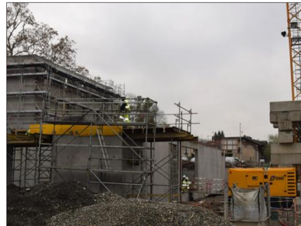
Au premier plan, les murs de la médiathèque s'élèvent. Au second plan, le prieuré est en cours de réhabilitation.
